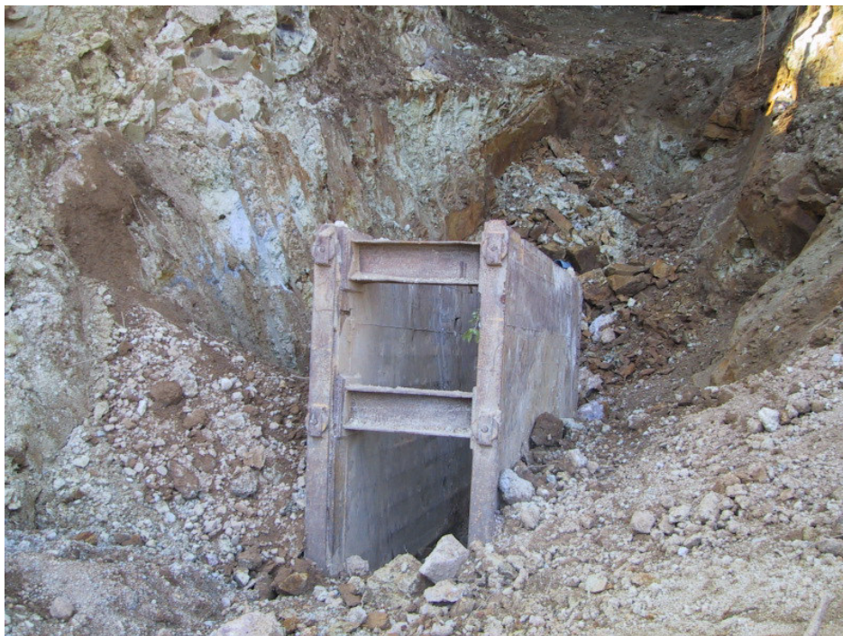
Figura 8.3: Struttura di armatura e puntellamento utilizzata in uno scavo supervisionato dallo scrivente.
